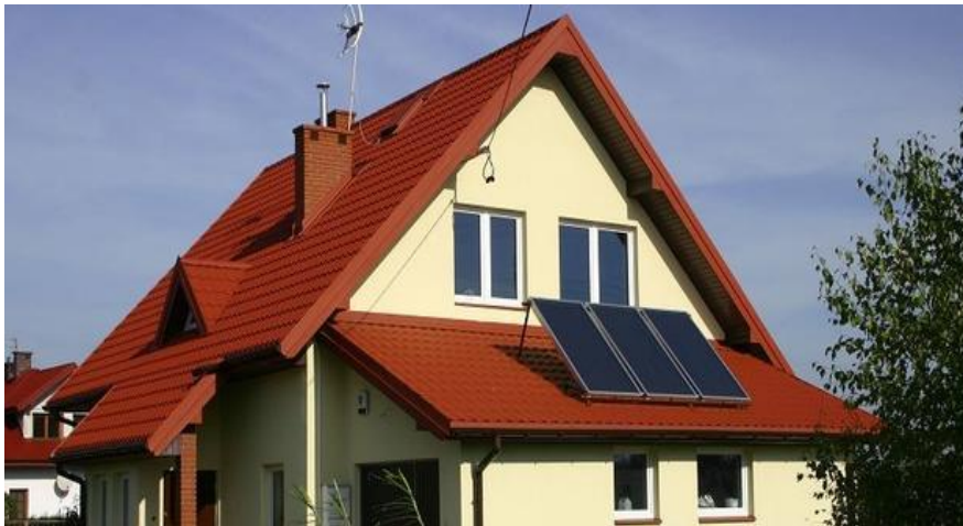
Zdjęcie 1: Kolektor płaski zamontowany na dachu budynku mieszkalnego.
