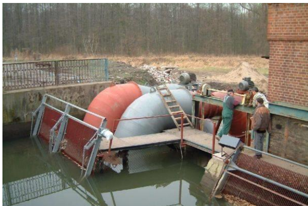
Zdjęcie 4: Mała elektrownia wodna.
