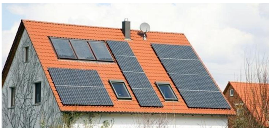
Zdjęcie 2: Zainstalowane na dachu budynku baterie słoneczne.
